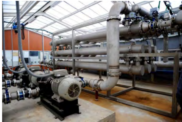
Figura 7: Estación de bombeo e intercambiador de calor sobre el pozo Barredo (Foto: Bastian Reker).
