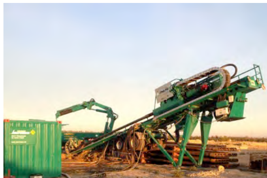
Figura 5: 250t-Plataforma de perforación.
