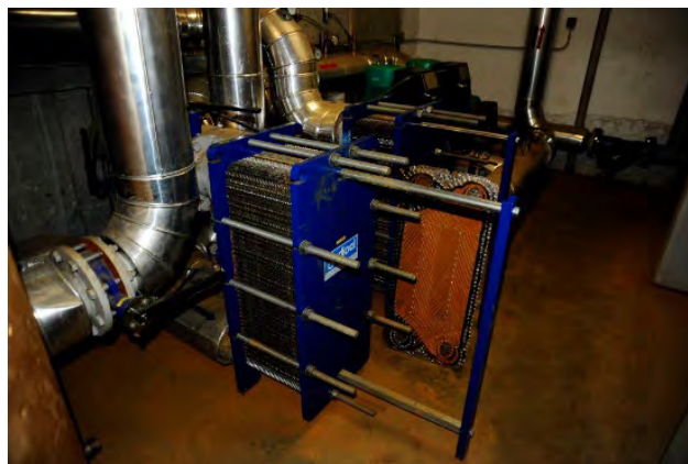
Figura 9: Un posible inconveniente del sistema de control de circuito abierto: la obstrucción en una placa extraída (mitad derecha de la imagen) del intercambiador de calor (izquierda de la misma en azul) en el Centro de Investigación Hunosa del Campus de Mieres. (Foto: Bastian Reker).
