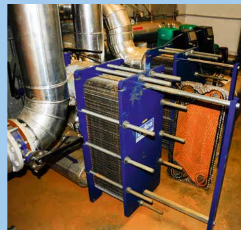
Abb. 56: Nachteil des Systems mit offenem Kreislauf: Verockerungen an den Wärmetauschern (ockerfarbene Bereiche auf der Metallplatte; Foto: Bastian Reker).
