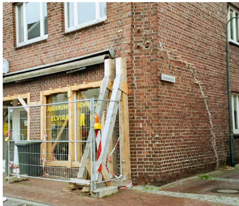
Abb. 38: Gebäudeschäden infolge des Grubenwasseranstiegs im Erkelenzer Steinkohlenrevier (Fotos: Volker Baglikow).
